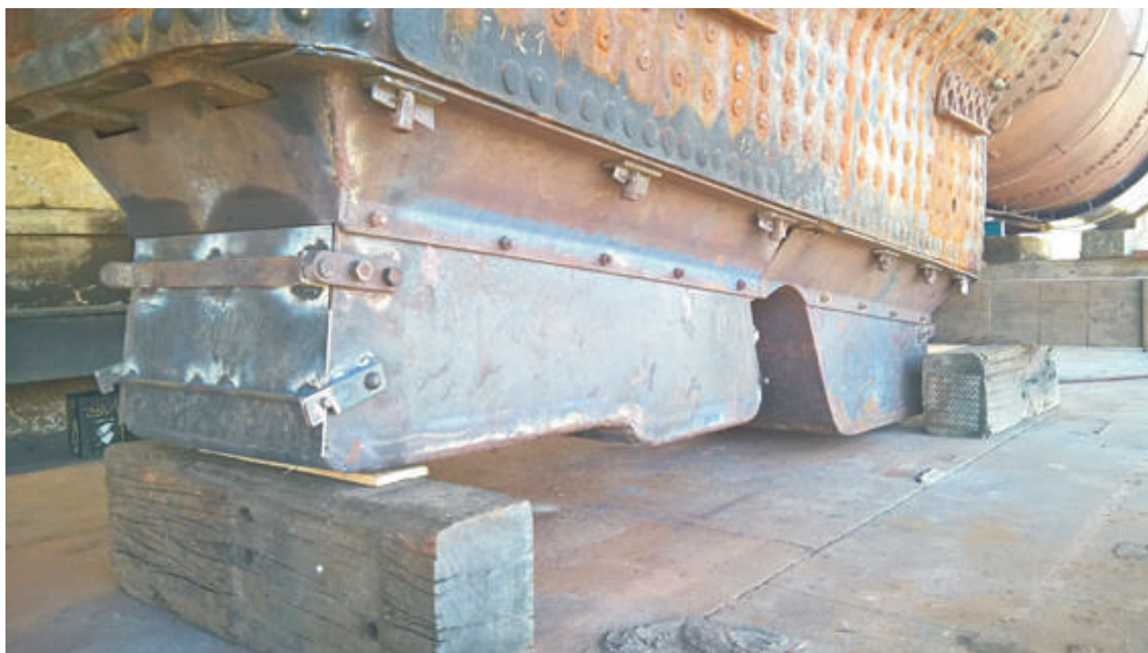
O novo cinzeiro pronto e já instalado abaixo da fornalha da 327
