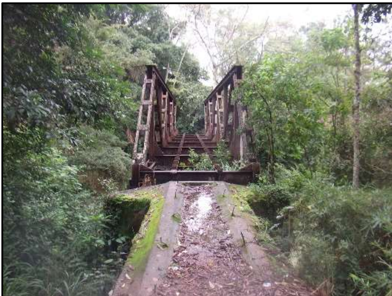
Ponte metálica da EFSC sobre o Ribeirão Encano em Indaial-SC. Patrimônio público do município, aguarda restauro desde 1991. Foto: Luiz Carlos Henkels em 26/06/2014.
