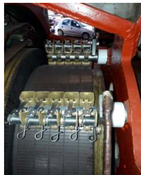
Gerador principal já com limpeza e revisão. Foto de Leonel Martins
