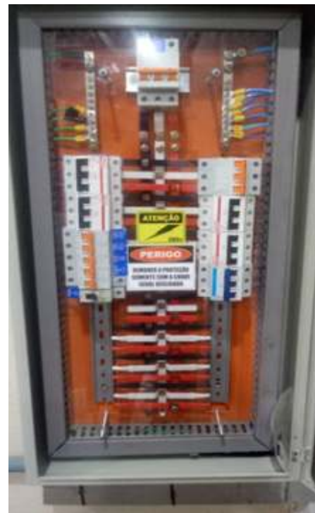
As novas caixas com disjuntores de distribuição na nova instalação elétrica no prédio da estação de Piratuba
