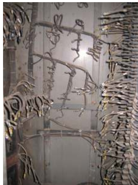
Parte da instalação original da Litorina, sem os componentes que foram retirados para reforma.
