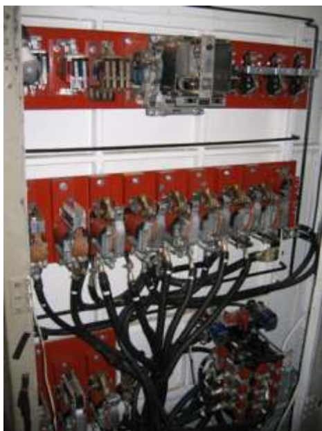
Painel elétrico da GE já concluído alta tensão. Foto de Helio Gazetta Filho.
