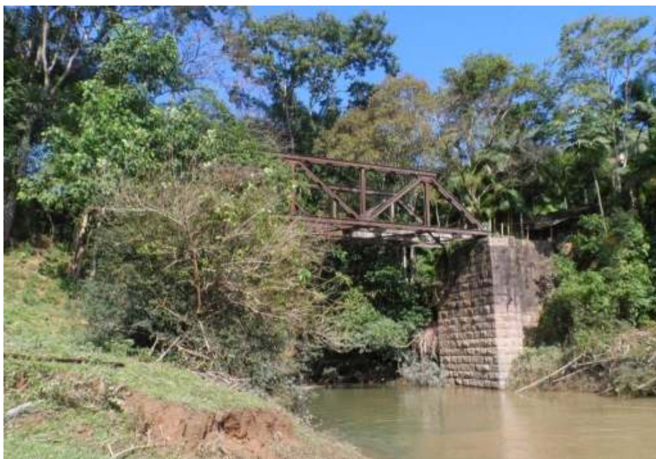
Ponte metálica de 110 anos, remanescente do "trecho Alemão", em estado de abandono sobre o Ribeirão Subida.(Vanderlei Antonio Zago)
