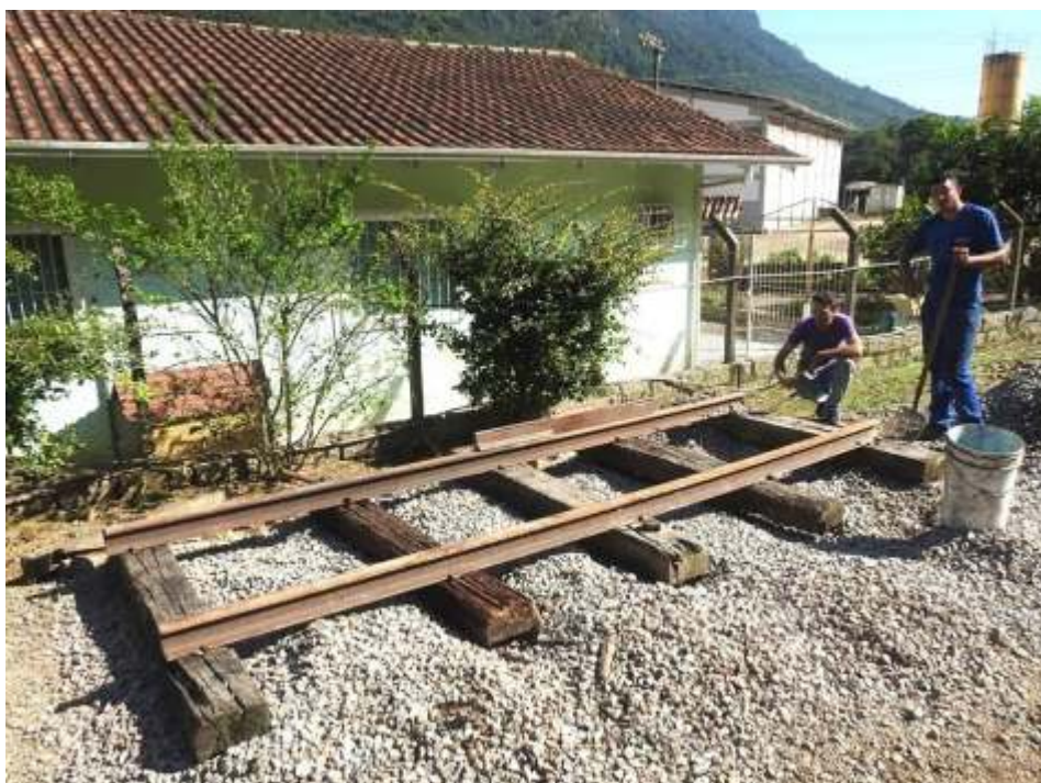
Otávio Georg Junior e Anderson Oliveira na construção da linha morta onde ficará estacionado o vagão CAP
