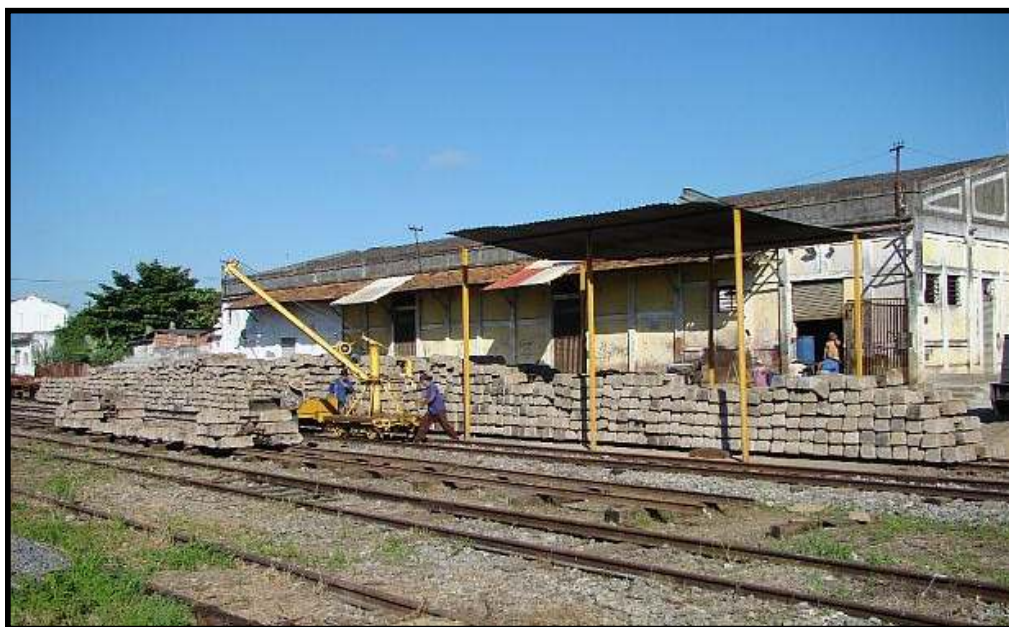
Estoque de dormentes de concreto bi-blocos que são re-bitolados nas Oficinas de Cruzeiro-SP para uso nas linhas da Regional Sul de Minas. Foto: Jorge Sanches.
