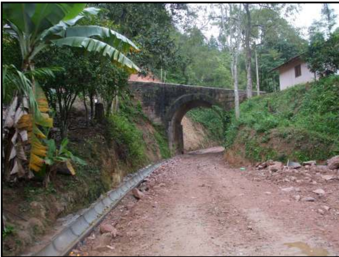
A passagem superior de subida, construída em 1925, onde o leito já recebeu nova base de pedra e nova canalização de água pluvial, onde há poucos meses havia um imenso lodaçal. Foto: Luiz Carlos Henkels em 27/06/2009.
