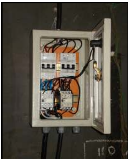
Painel de controle de um dos equipamentos das Oficinas de Carlos Gomes. Essa modernização das instalações vem sendo executada pelo associado Cristiano Belarmino. Foto: Cristiano Belarmino.
