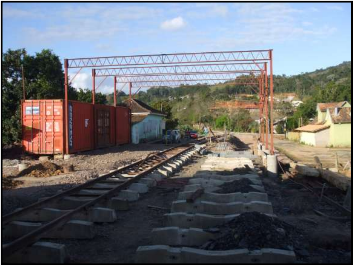
Aspecto do início da construção do galpão para a oficina de manutenção, no momento alocada no container à esquerda na foto.
