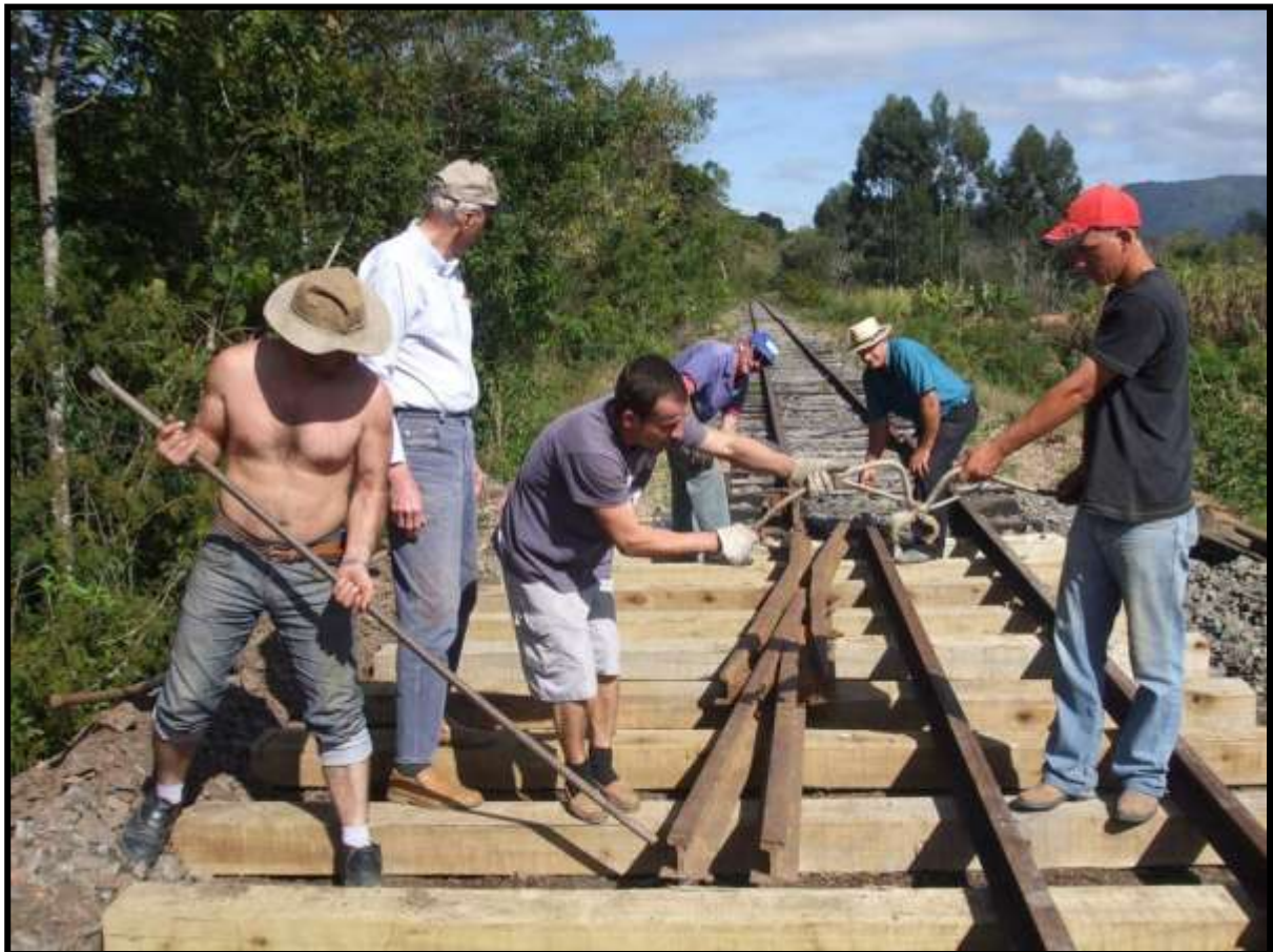
Início dos trabalhos de instalação do AMV em Matador. Da esquerda para direita os associados Marciano Pereira, Germano Purnhagen, Marcelo Montibeller, Charles Thurow e mais dois contratados. Foto: Luiz Carlos Henkels em 22/08/2009.
