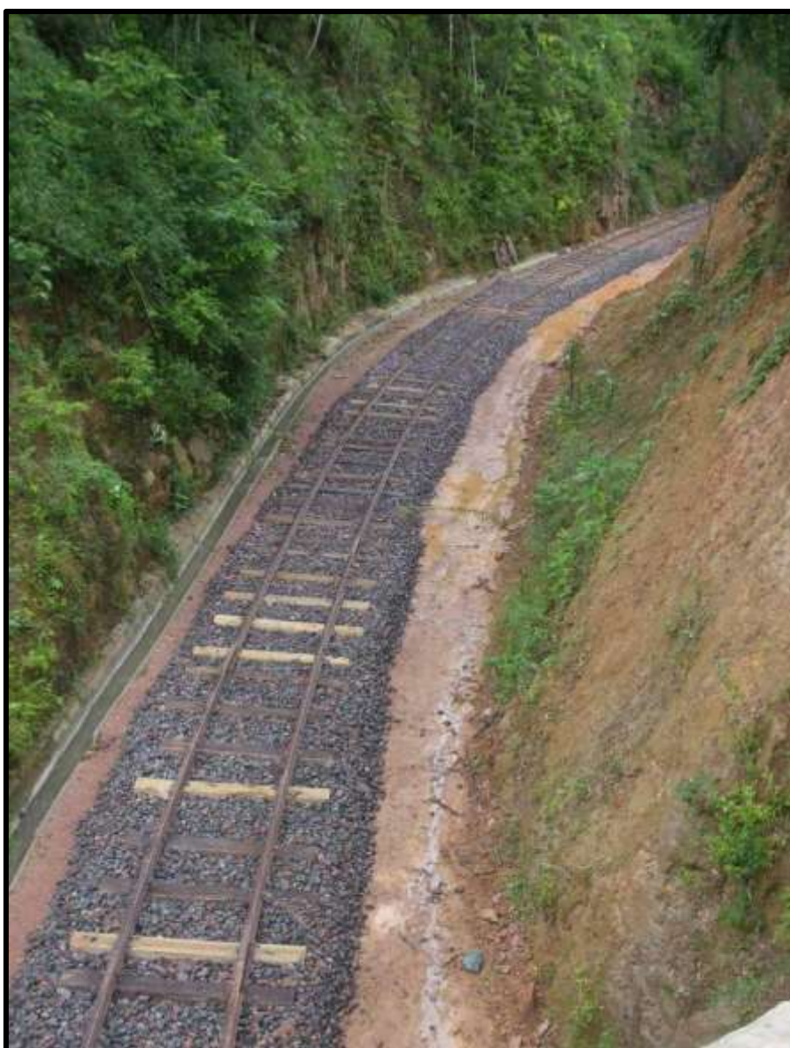
Linha concluída atravessando o corte de Subida, numa vista de cima da passagem superior.
