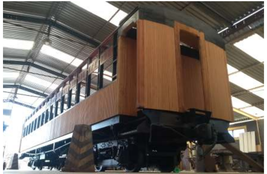
◆ Aspecto geral do carro no final do mês de fevereiro: boa parte do novo revestimento externo já foi instalado.
