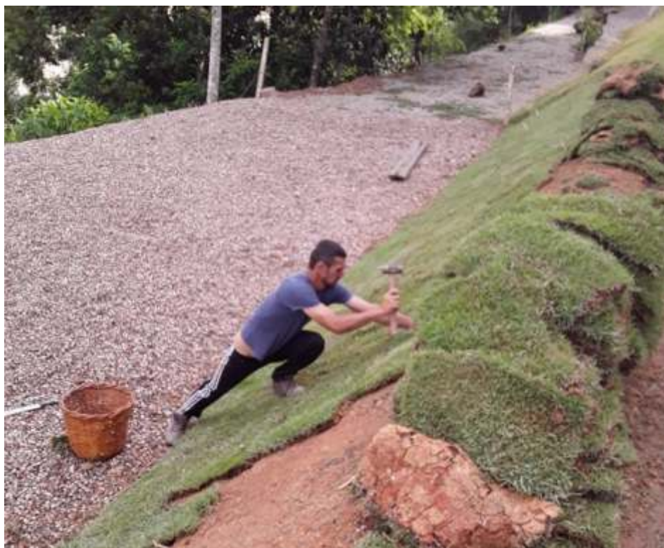
◆ Colocação do gramado na encosta rente ao mirante. Foto: Otávio Georg Junior
