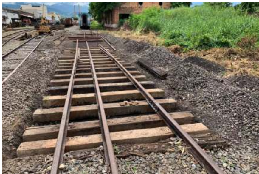
◆ Trabalhos em andamento: remoção do lastro para descontaminação e substituição dos dormentes
