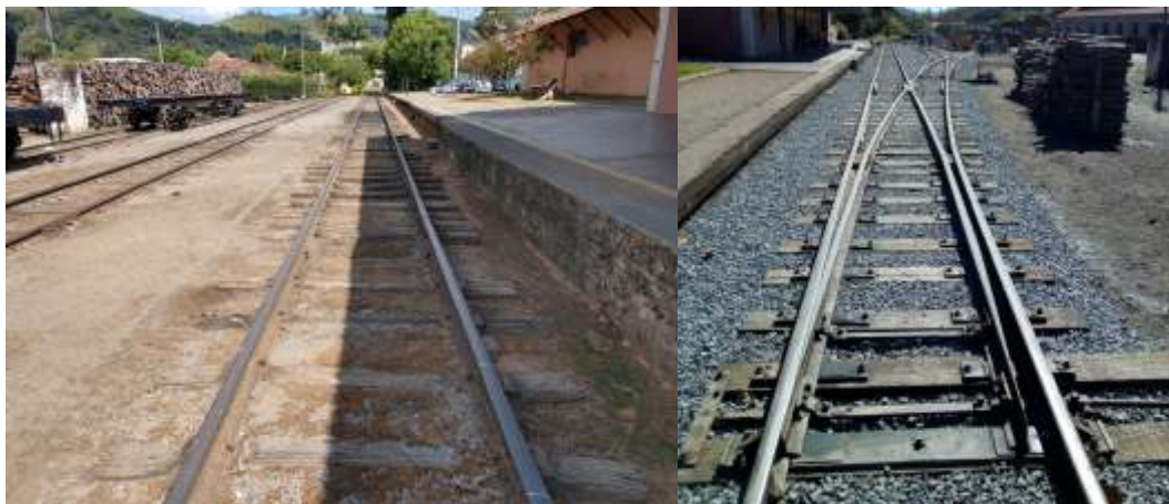
+ Pátio da estação de Passa Quatro antes e após a conclusão das obras
