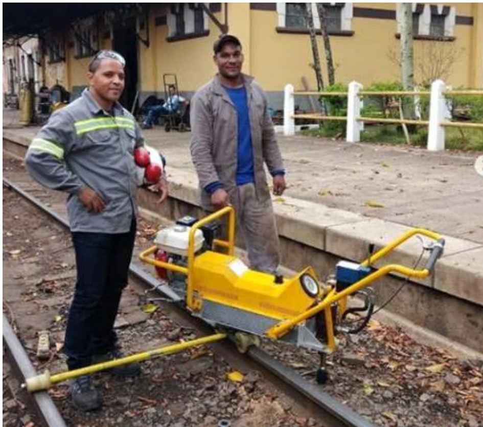
♦ Vista do equipamento da Brastan sendo recebido e testado em Carlos Gomes
