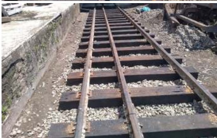
♦ Reforma das vias em Cruzeiro: limpeza, descontaminação de lastro e substituição de dormentes
