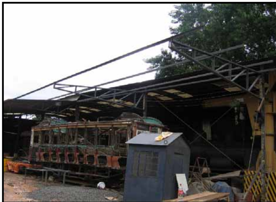
Construção da cobertura para o bonde nas Oficinas de Carlos Gomes, em Campinas-SP. Foto: Helio Gazetta Filho em fevereiro de 2008.
