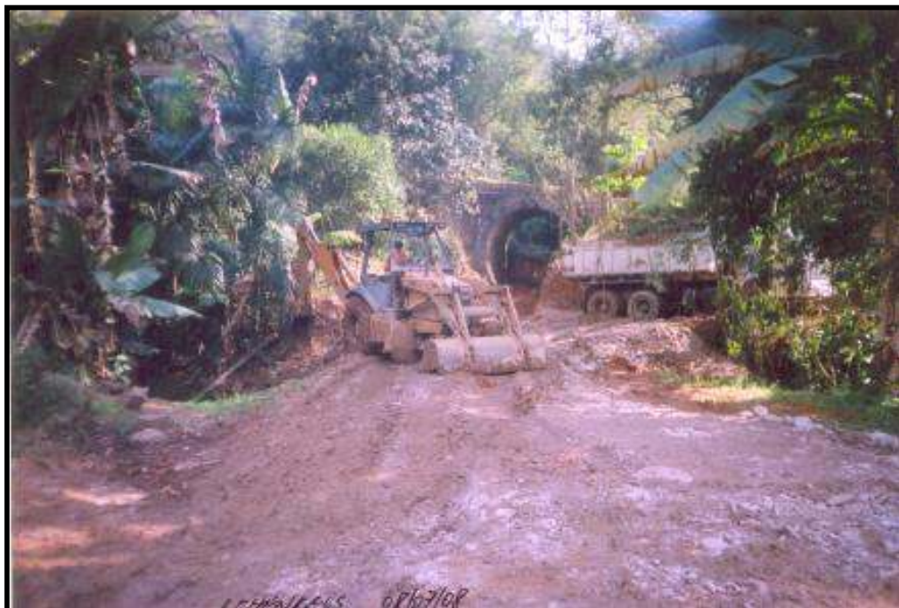
Trabalhos de limpeza no leito da EFSC sendo executados pelo maquinário da Prefeitura de Apiúna, vendo-se mais adiante a passagem superior construída entre os anos de 1924 e 1925. Foto: Luiz Carlos Henkels em julho de 2008.
