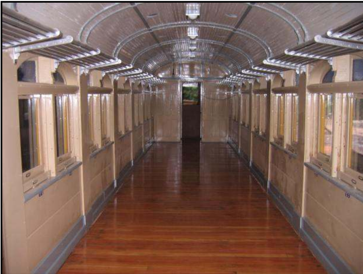
Interior do carro CA-36 após restauração do piso original e aplicação de resina. Este trabalho foi executado nas Oficinas de Carlos Gomes. Foto: Helio Gazetta Filho em dezembro de 2008.
