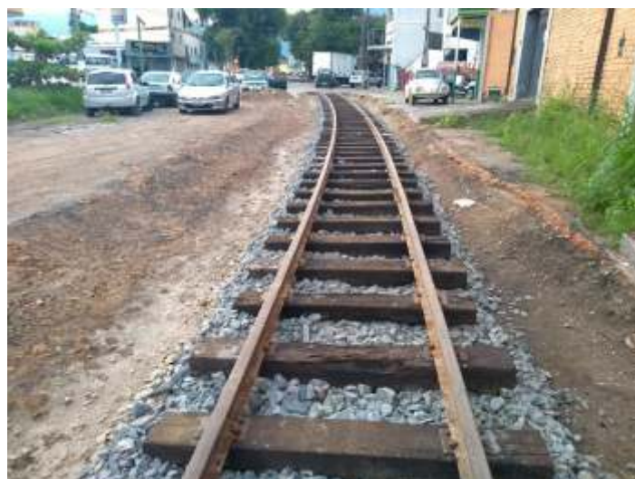
◆ Troca da dormentação completa entre a estação e a segunda passagens em nível, agora rumo a rua 3. Também já foi colocada a primeira camada de lastro
