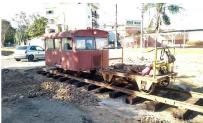
♦ Auto-de-linha com vagonete já circulando pelo trecho desaterrado e com dormentação nova
