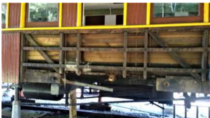
◆ Preparação do carro C 2 para e retirada de viga lateral externa apodrecida. Autoria de Otávio Georg Junior
