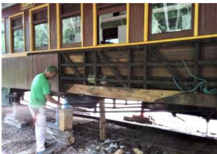
◆ Nova viga já devidamente recolocada e encaixada. No detalhe o carpinteiro Dierres Ferreira Freitas. Autoria de Otávio Georg Junior
