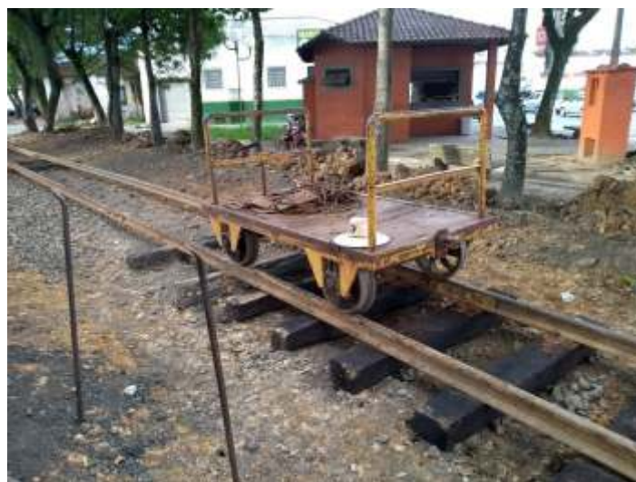
◆ Após abertura das PN's para deixar os trilhos expostos, permitiu-se a circulação no trecho dos vagonetes e em breve, trens de serviço, fundamentais para prosseguirmos com os trabalhos de recuperação da linha
