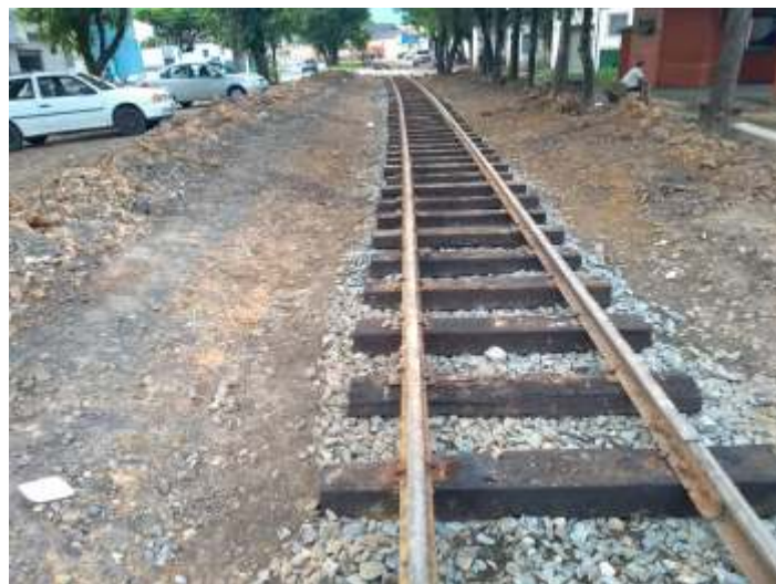
◆ Troca da dormentação completa entre a estação e a segunda passagens em nível, agora rumo a rua 3. Também já foi colocada a primeira camada de lastro.
