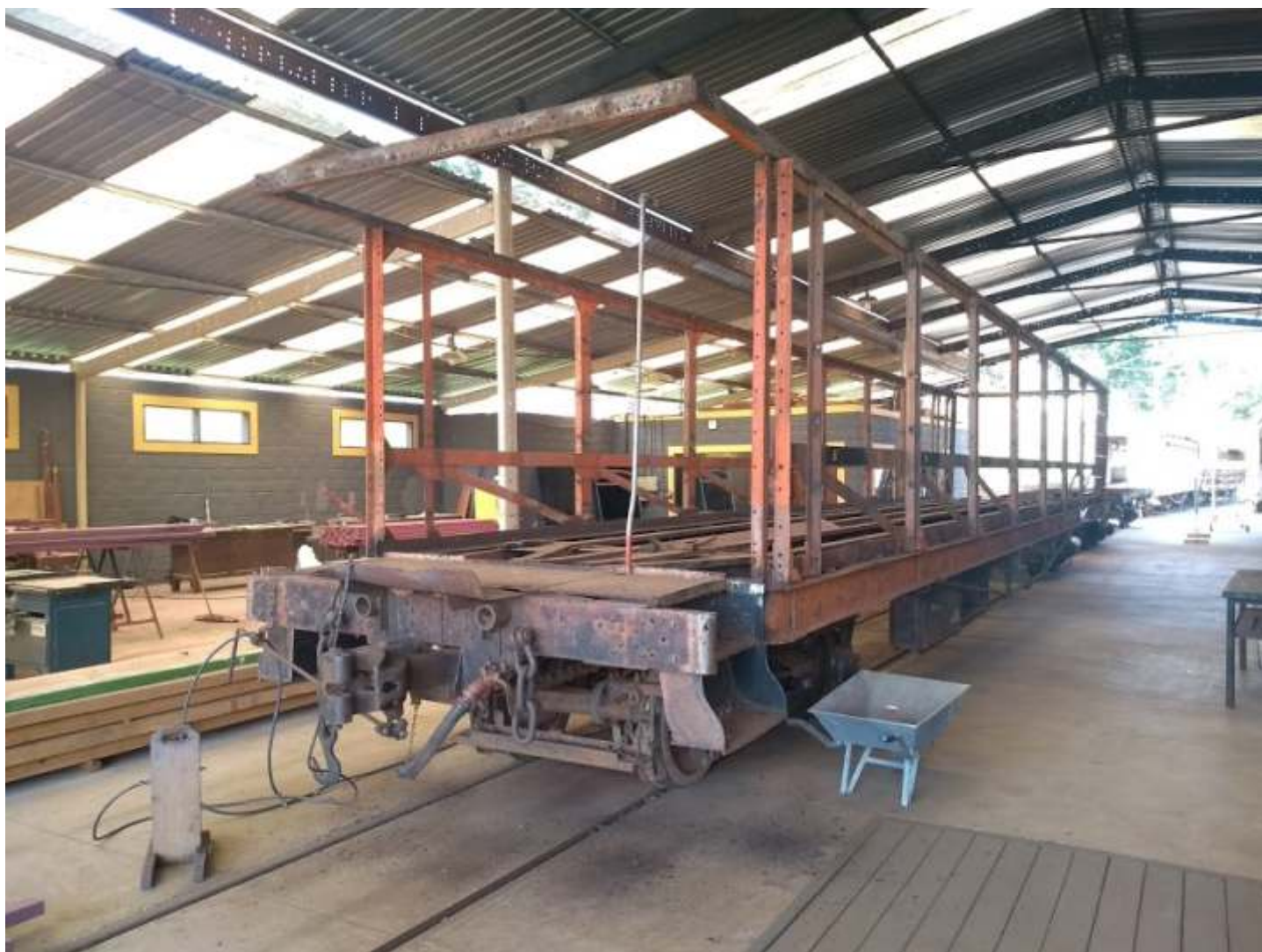
♦ Após a remoção de todo o madeiramento do carro ex. EFS, toda a estrutura metálica foi limpa
