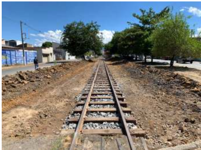
♦ Obras no trecho entre as Ruas 6 e 7: durante e após a conclusão dos trabalhos; resta agora apenas complementar o lastro
