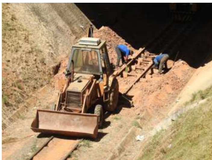
♦ Limpeza e descontaminação do lastro, causado devido construção das pontes da Rodovia D. Pedro I, próximo a Anhumas. Foto de Vanderlei Zago
