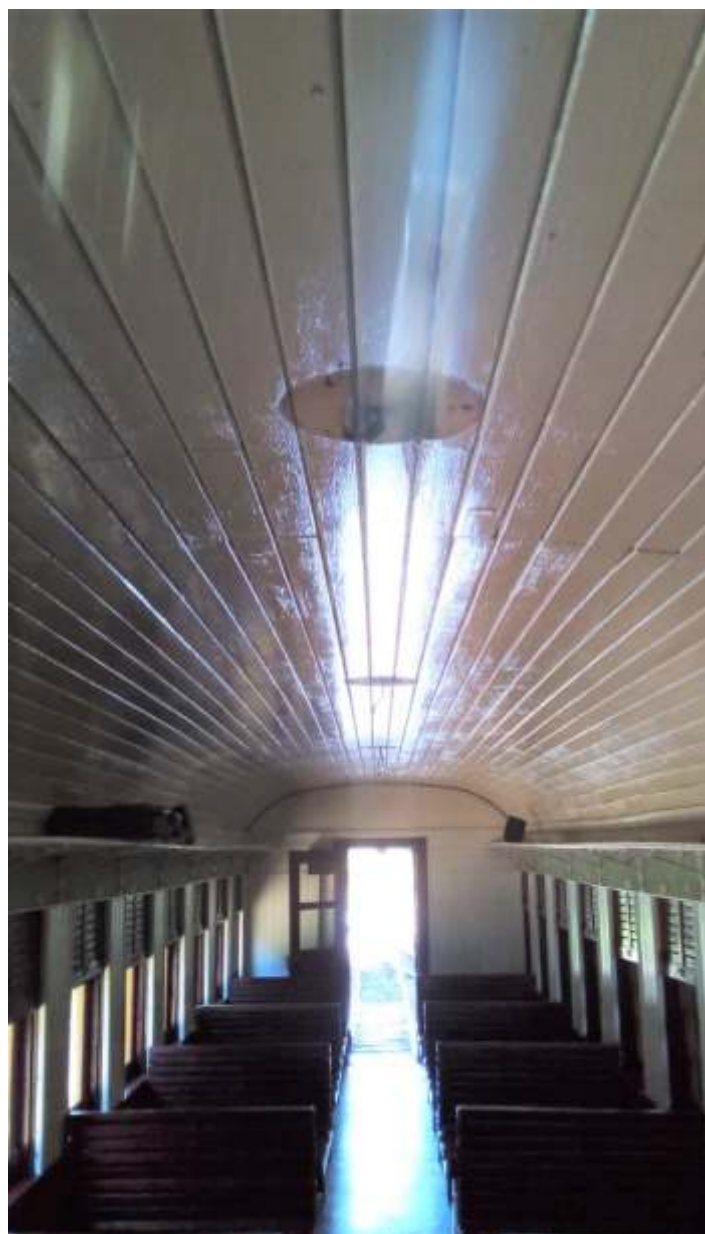
◆ Faltando repor as luminárias, o carro C02 volta a ostentar seu original forro em madeira. A autoria de Otávio Georg Junior
