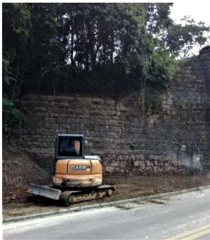
♦ A base do viaduto de dois arcos também recebeu esmerada limpeza. Autoria de Otávio Georg Junior
