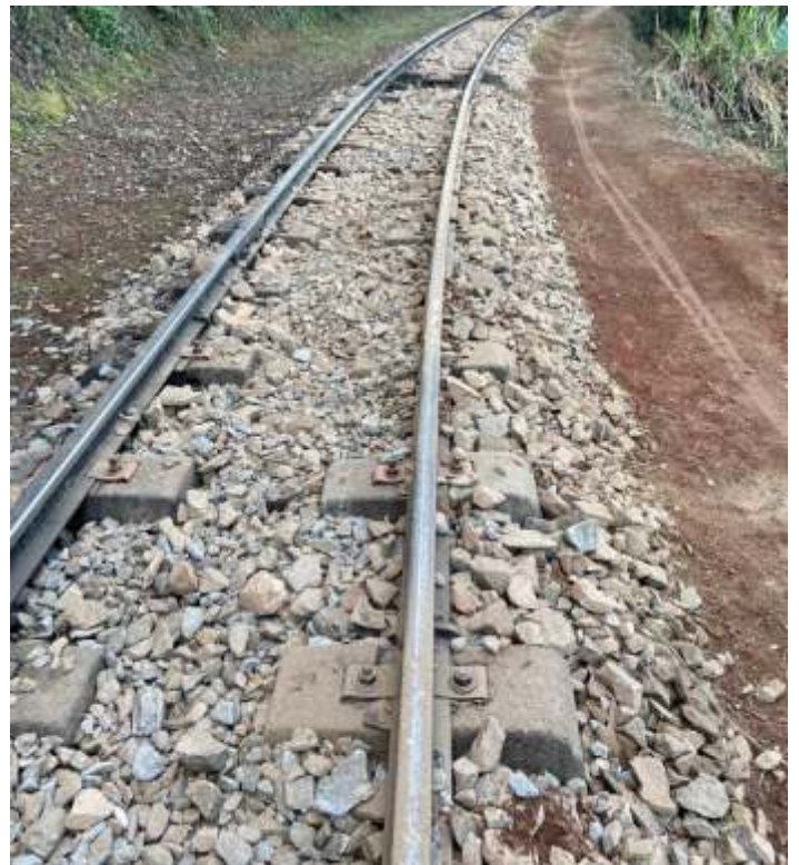
◆ Obras no km 87+150 antes e depois: a via foi alinhada e nivelada e o lastro descontaminado além de complementação do mesmo.
