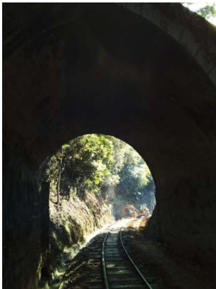
♦ Retirada de barreira na boca do túnel. Autoria de Otávio Georg Junior
