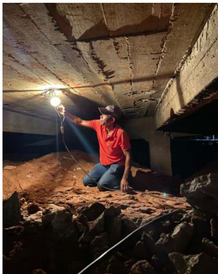
◆ Verificação das fundações e das estruturas do piso da estação de São Lourenço.
