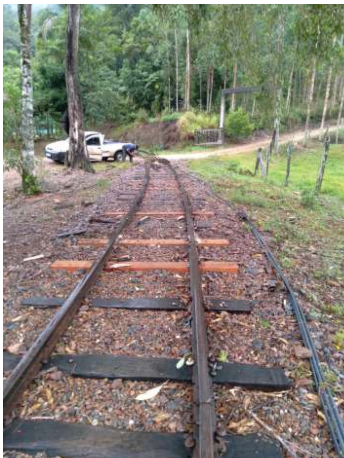
♦ Troca de dormentação em direção à passagem em nível proximidades do túnel. A autoria: Otávio Georg Junior
