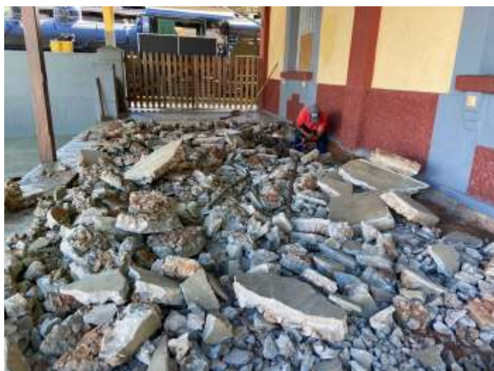
◆ Remoção do piso da plataforma lateral esquerda da estação de São Lourenço
