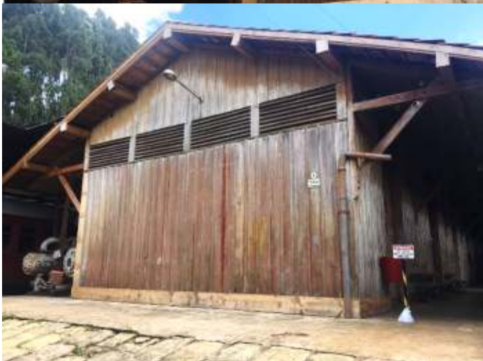
◆ Troca de madeiramento comprometido do armazém de cargas da estação de Rio Negrinho.
