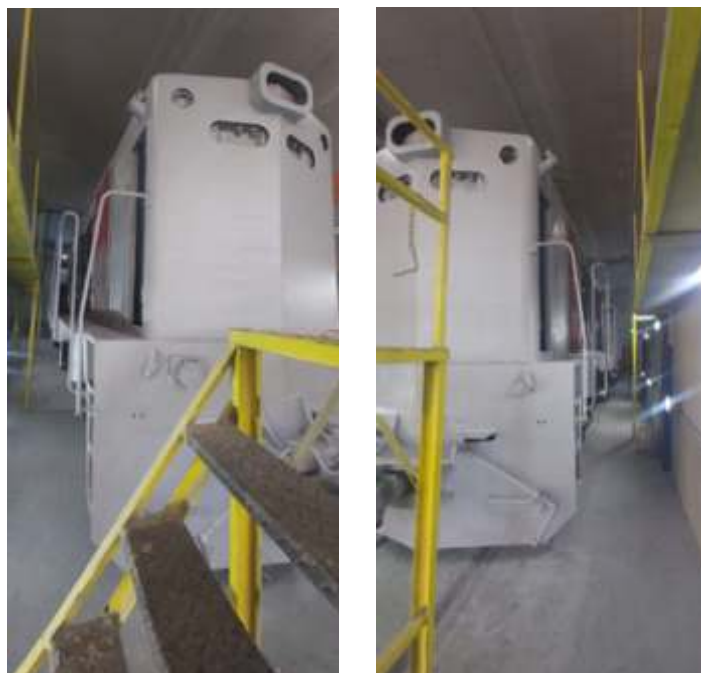
♦ Finalização da reconstrução da funilaria e pintura de fundo na cabeceira longa da locomotiva EMD GL8, nº 4026.
