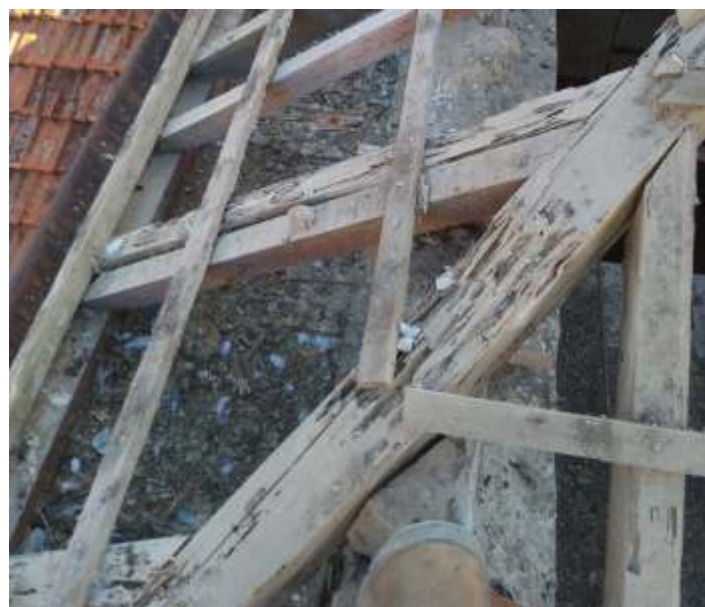
◆ Obras em Passa Quatro: madeiramento comprometido.
