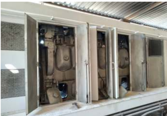
♦ Portas de acesso ao motor diesel já alinhadas.
