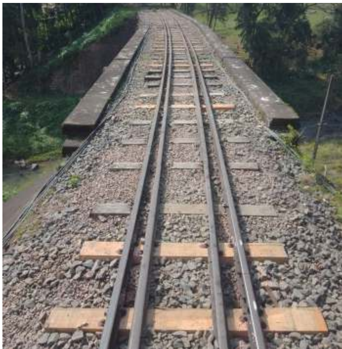
◆ Dormentes novos assentados sobre a ponte/viaduto em arco. A autoria de Jefferson Dhein.
