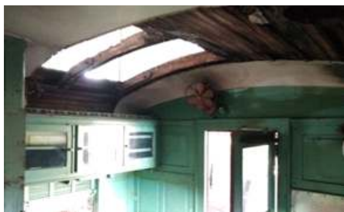
♦ Início dos trabalhos de remoção do madeiramento comprometido no teto do carro.
