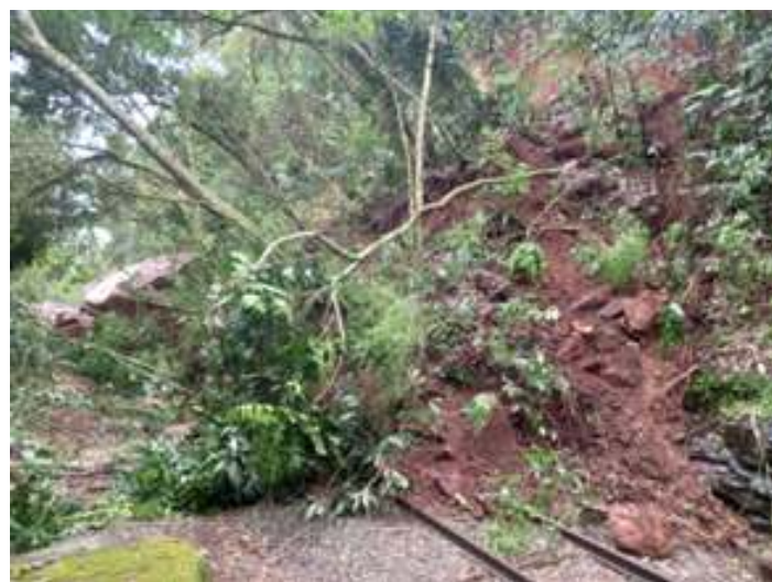
♦ Queda de barreira sobre a via férrea, Km 840 + 250.
