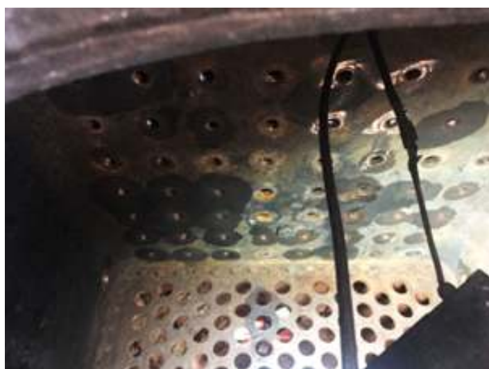
◆ Visão da fornalha com estais já removidos do espelho superior.
