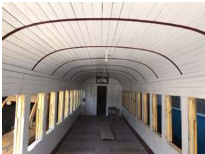
♦ Aspecto interior do carro de passageiros PD-42 já com os arcos do teto e rodapés instalados.
