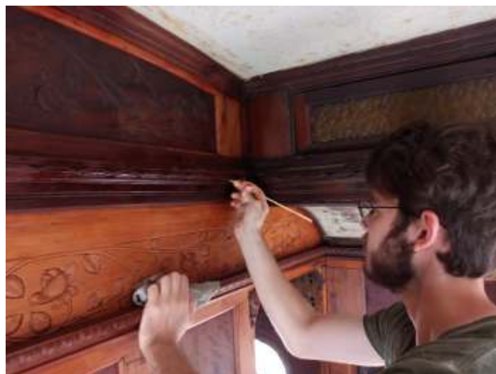
♦ Restauração e limpeza dos entalhes na sala do AM6. No detalhe o associado Hiago Tissiani. A autoria de Otávio Georg.
