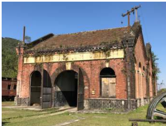
♦ Remoção de plantas e vegetação que se acumulam nos telhados das edificações da chamada “5ª Machina” que, devido ao clima local, tem um acentuado crescimento.
