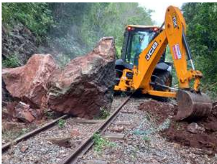
♦ Queda de barreira no Km. 855
