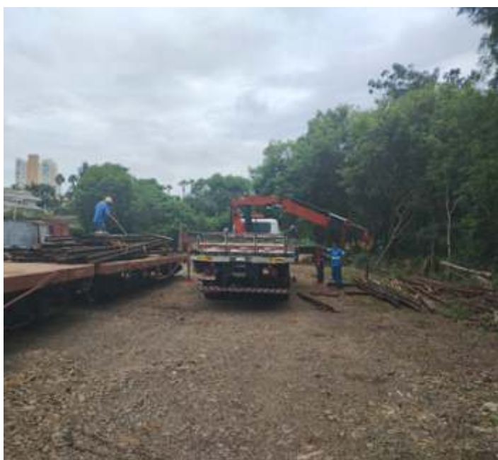
◆ Retirada e separação de trilhos que estavam atrás das longarinas. Foto HGF.
