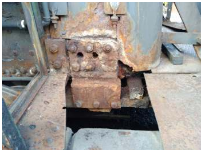
◆ Detalhe do local onde havia vazamento de um estal.
