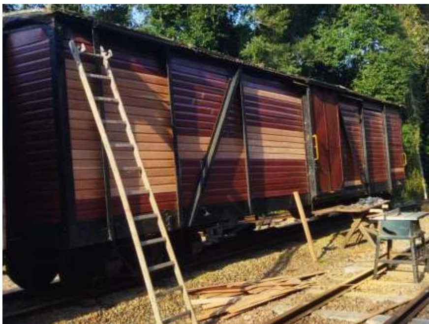
◆ O vagão VF129 passando por troca de madeiramento de sua caixa. Este vagão tem truques Americanos marca Symington e rodeiros Sofunge e nos serve como almoxarifado. Autoria de Otávio Georg Jr..
