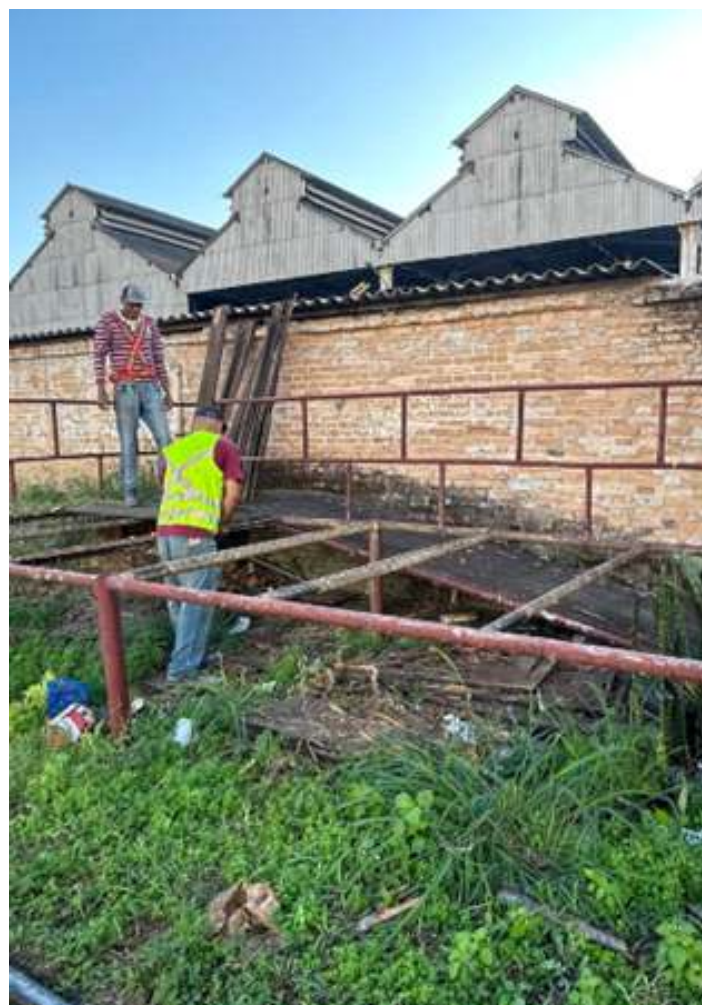
◆ Plataforma sendo desmontada para abrir espaço para a construção da nova em alvenaria.
