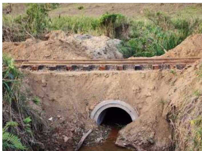
◆ Aspectos do antes e depois da recuperação de boeiro na altura do km 4+900 bem com da linha, já com dormentação nova. O trabalho ainda não foi finalizado mas já permite a passagem do auto-de-linha com a equipe e materiais.
