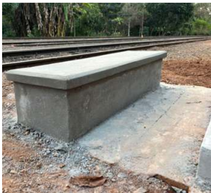
◆ Reforma das alvenarias dos bueiros do pátio de Anhumas. Foto Eric Gazetta.
