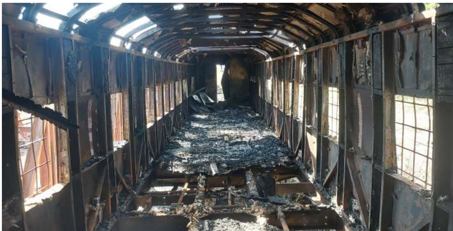
◆ Aspecto interno do carro QC-3062 após o incêndio. Foto: Douglas Ruzzon.
