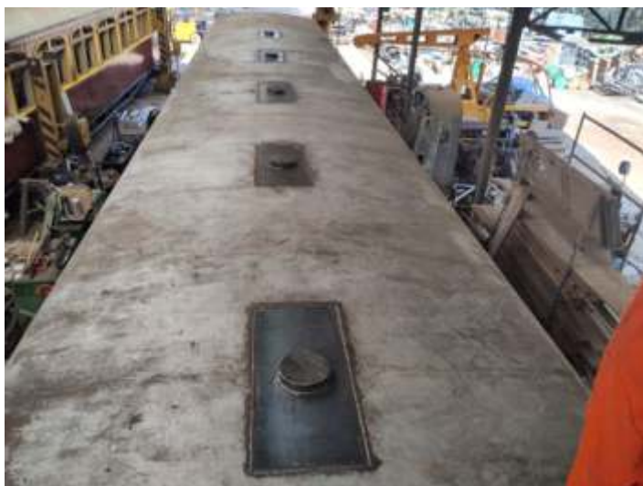
◆ Reparos no teto, onde havia enormes buracos. Foto HGF
