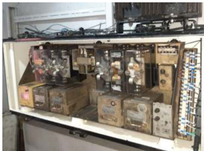
◆ “Box” do sistema ATC instalada no compartimento CDC da locomotiva nº9380.
