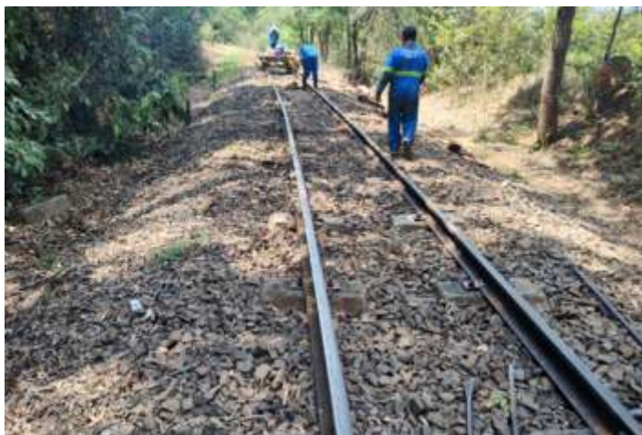
♦ Inversão das barras de trilhos (lado direito da foto). Foto Márcio Silva.
