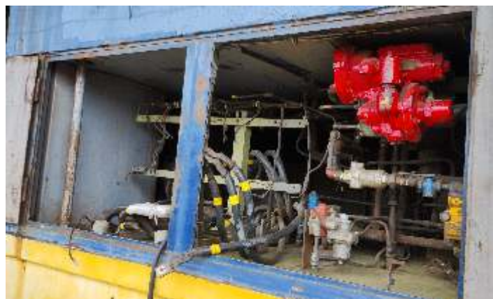
♦ O sistema elétrico da 3111 está sendo revisado.
