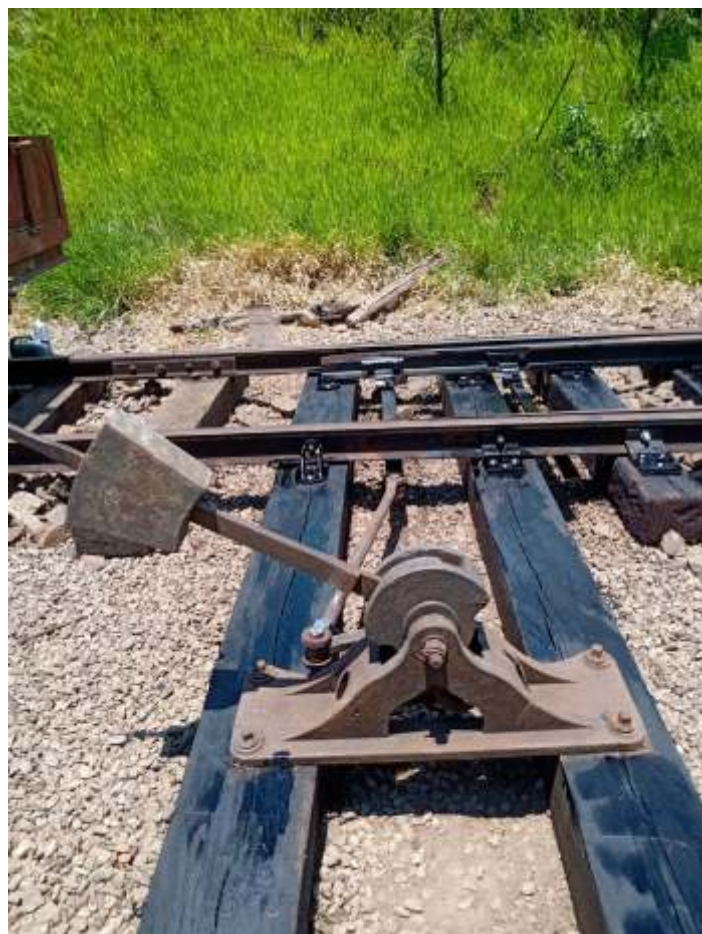
◆ Instalação do aparelho de manobra do AMV do pátio de Rufino de Almeida.
