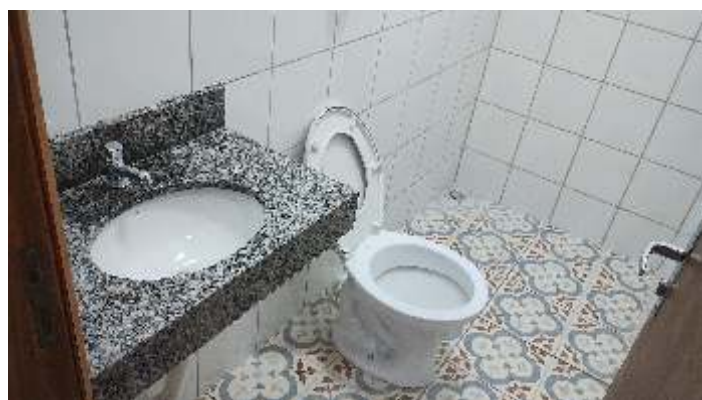
◆ Aspecto do novo sanitário para uso exclusivo das colaboradoras do trem.
