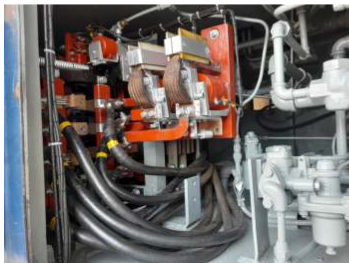
♦ Contadoras, cabeamento e sistema de freio revisados.
