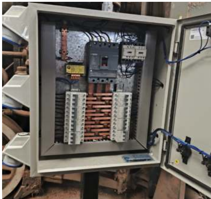
♦ Interior do novo painel elétrico. Foto Cristiano Belarmino.
