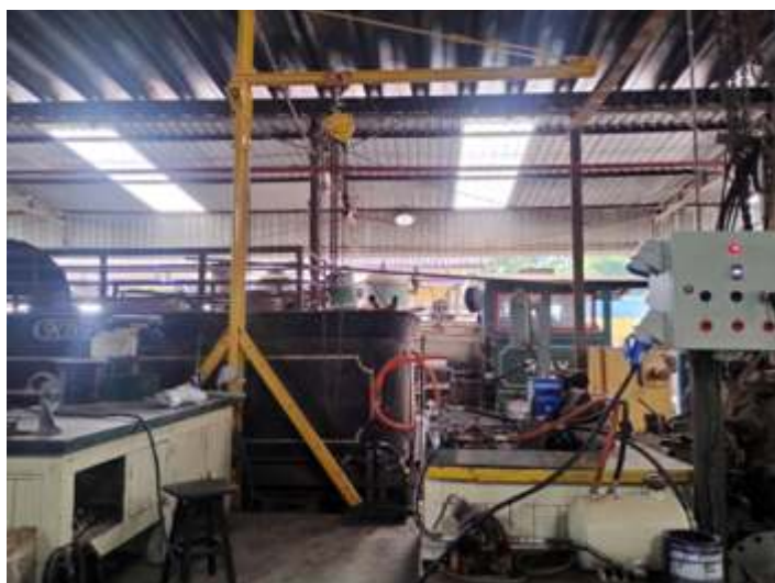
♦ Outro pórtico instalado na seção de diesel. Foto HGF.
