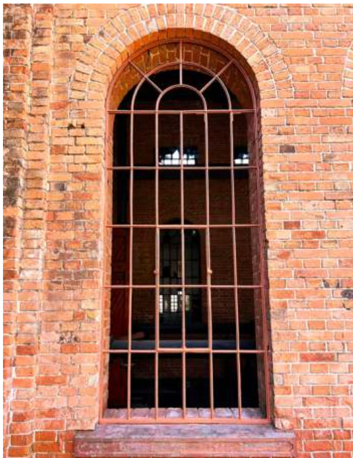
♦ Uma das janelas já sem os vidros, e após raspagem da estrutura de aço para retirada de ferrugem. Foto: Alexandre A. Pisciotano.
