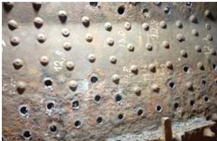
♦ Aspecto da chaparia da fornalha após a remoção de estais comprometidos.
