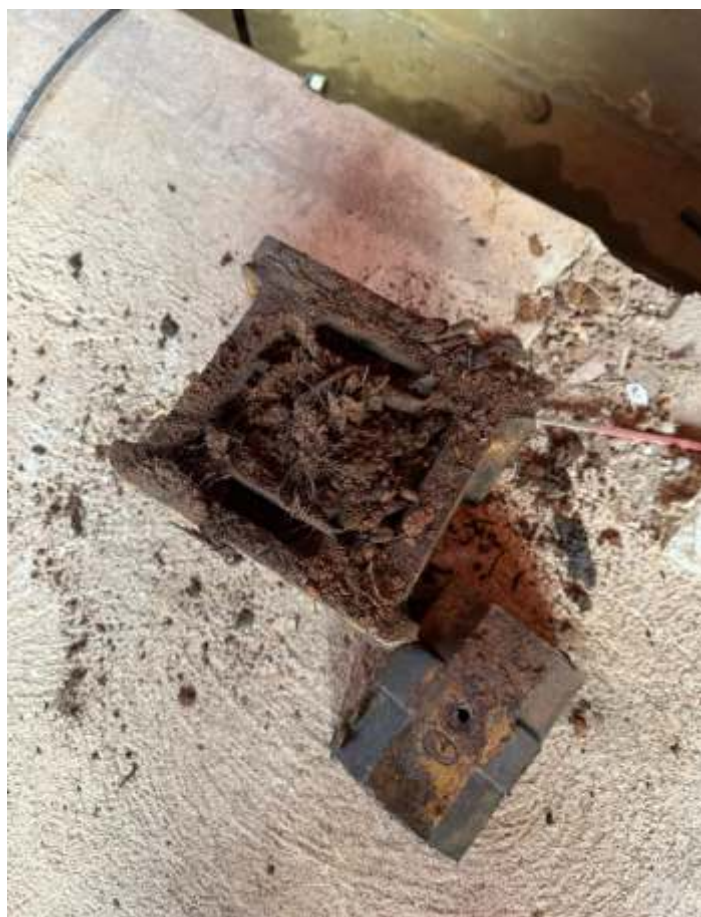
♦ Aspecto da contra-caixa da roda guia, completamente lotada de lodo seco.
