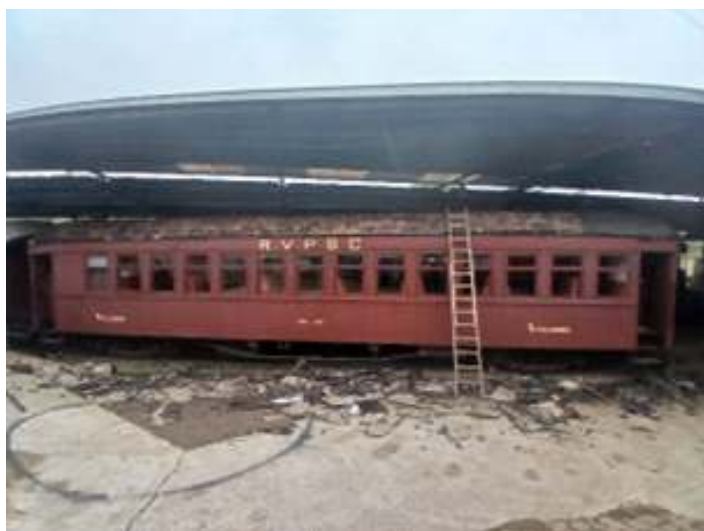
♦ Aspecto do carro de passageiros PD-42 com a manta asfáltica completamente removida.
