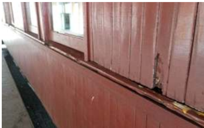
♦ Aspecto do madeiramento bastante comprometido e apodrecido.
