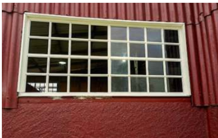
♦ Reparo na parte envidraçada faltante da estrutura, lado esquerdo do Museu.
