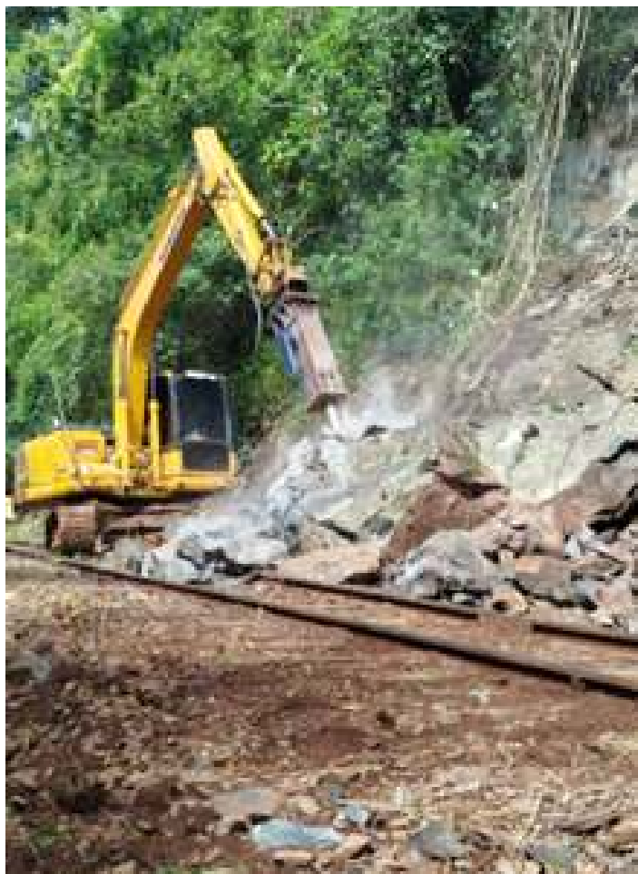
♦ Queda de pedras sobre a via e remoção de material com uso de rompedor no km. 842+800.
