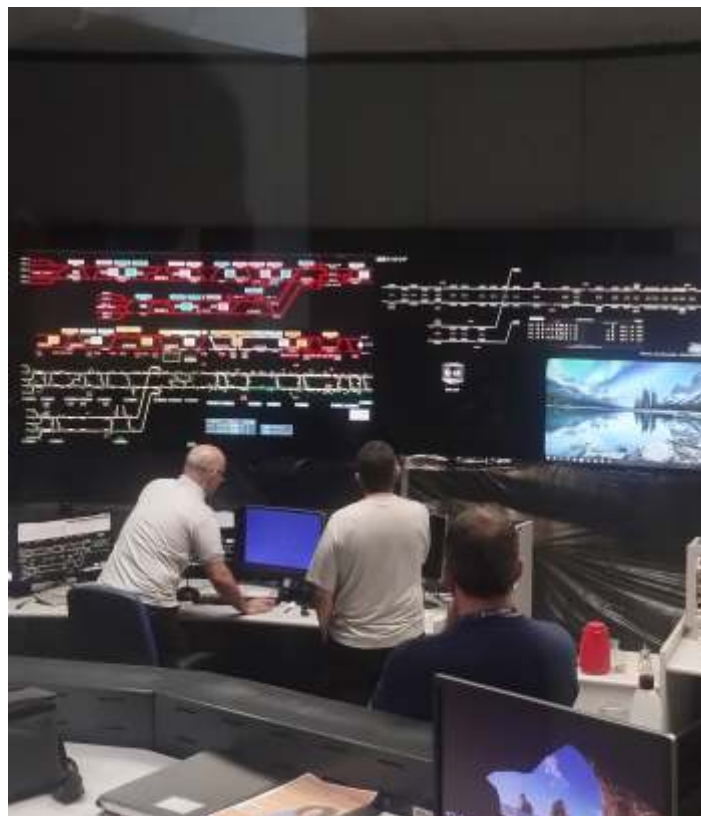
♦ Visita técnica na sede do Metrô DF acompanhada pelo sr. Luciano Scartezini: vista do CCO.
