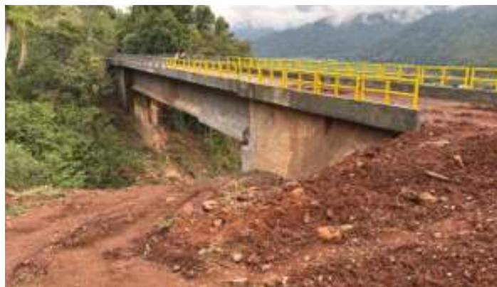
♦ Reposicionamento do viaduto, anteriormente deslocado.
