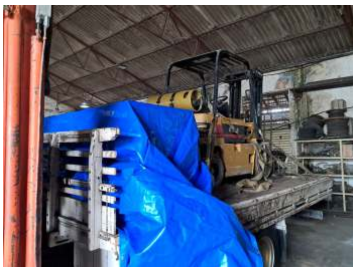
♦ Chegada do novo gerador nas oficinas de Cruzeiro, onde foi confeccionado o suporte para instalação.
