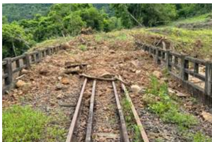
♦ Aspecto do viaduto V-08 após as enchentes de maio de 2024.
